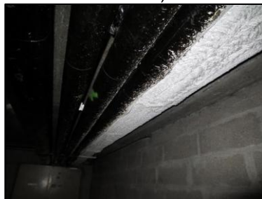
Photo N° 941 AMIANTE CIMENT -- COULOIRS -1 Gaines & coffres horizontaux Ventilation haute (Fibres-ciment)
