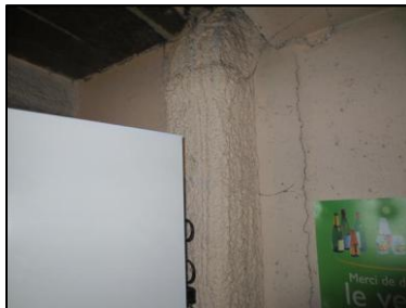
Photo N° 938 AMIANTE CIMENT -- LOCAL VO -1 Gaines & coffres verticaux Ventilation haute (Fibres- ciment)
